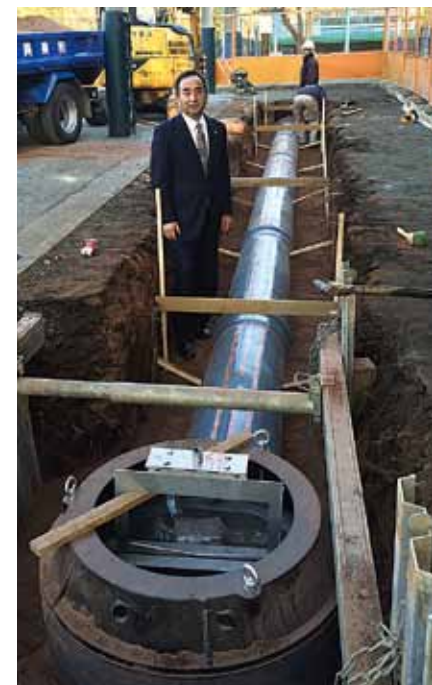
マンホールトイレ(三ツ境小)
